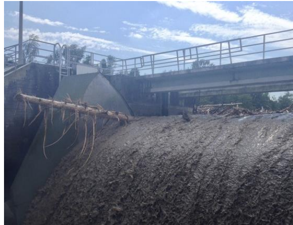
Ganze Baumstämme bleiben im Wehr des Laufkraftwerk Flumenthal hängen.
